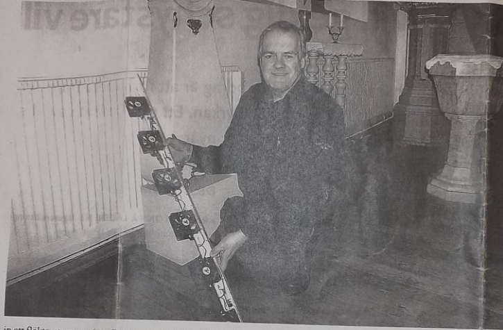
Fläktarna placeras i underkant av elementen. De suger in kallluften, som värms upp och fördelas jämnt. FOTO: ANITA BOND
